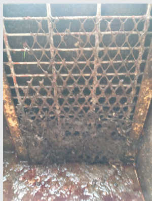
Figura 1. Estado actual de la rejilla de desbaste del matadero municipal, donde se observa colmatación severa por sólidos orgánicos.
