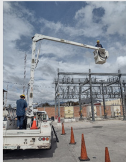
Figura 4. Operación de giro de un equipo hidráulico de elevación de canastilla sencilla. Fuente: Elaboración propia.
