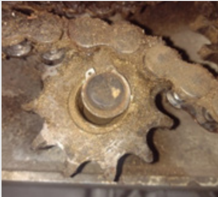
Figura 2. Bujes de Catarina de sistema de nivelación de canastilla con desgaste severo. Fuente: Elaboración propia.
